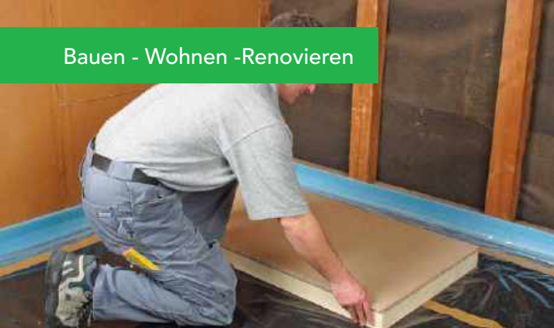
Eine Dämmung auf der obersten Geschossdecke ist leicht einzubauen und sinnvoll, wenn der Dachboden nicht als Wohnraum genutzt werden soll. Foto: djd/puren
